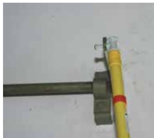
Manövrering av fränkskiljare med användning av manöverstång IS SK med manöverhuvud SSK.
