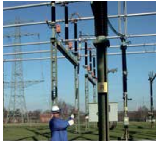
ASP Distansspänningsprovare under användning i ett utomhus-ställverk.
