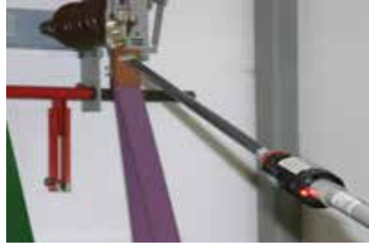
PHE III Spänningsprovare med synlig och hörbar indikering under spänningstest i ett inomhusställverk.
